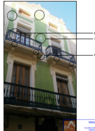
UBICACIÓN DE DEFECTOS EN LA FACHADA
